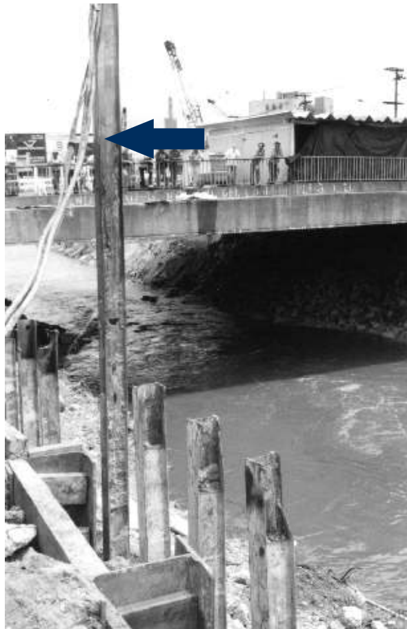
Fotografia 4 - Estaca metálica da ponte Wandenkolk, removida após mais de 20 anos de uso
