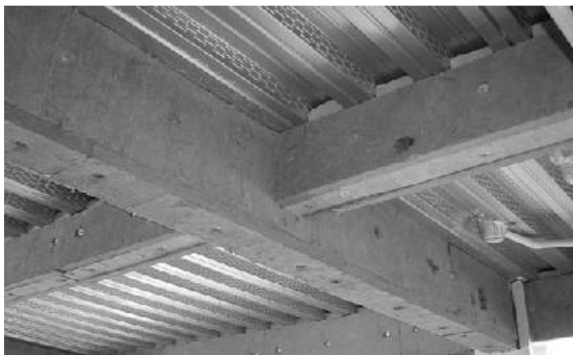
Figura 54: Vigas protegidas por lã de rocha basáltica.
