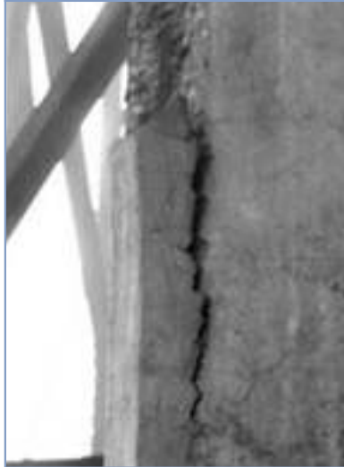
Figura 40 - Lascamento explosivo (spalling) em pilar de concreto.
