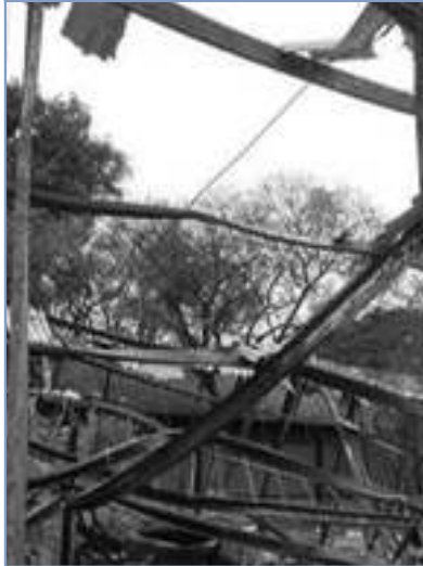
Figura 39 - Efeito do incêndio em elemento isolado de aço.
